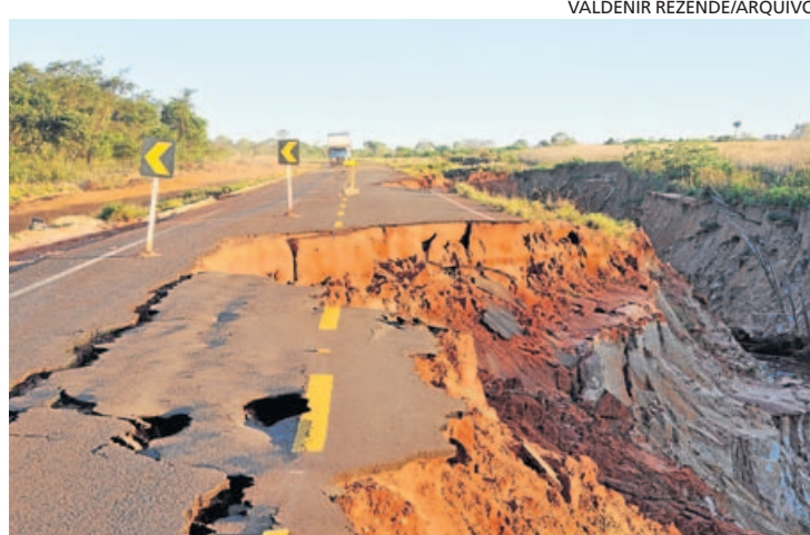
EM RUÍNAS. Depois de chuvas fortes entre fim de 2015 e início de 2016, MS-180 ruiu, meses depois de ter sido inaugurada
