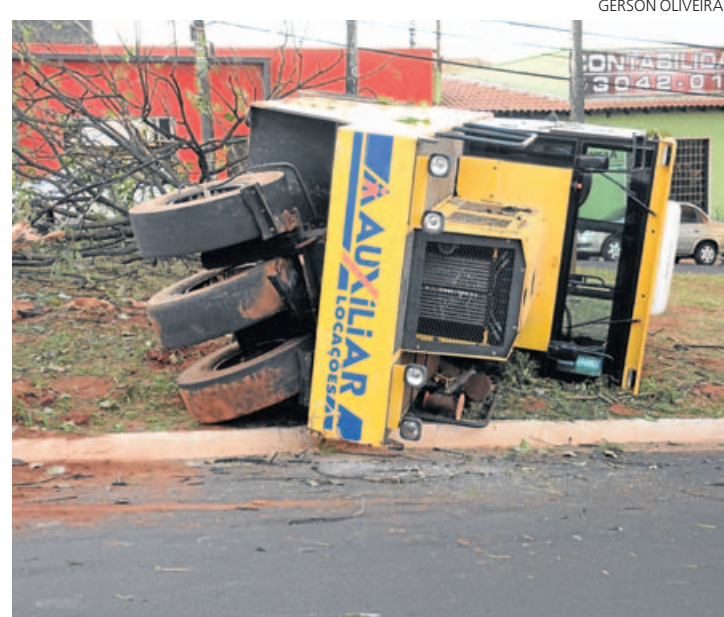
OBRA. Compactador de asfalto tombou na Avenida Mato Grosso
